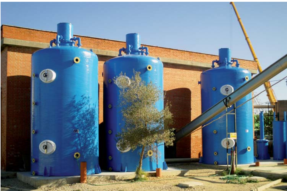
Fig. 6. Reactores UASB prototipo
