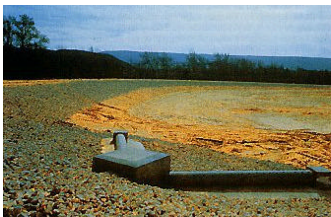
Foto 11.3. División del caudal a la entrada en una laguna facultativa para mejorar la mezcla en ésta (cortesía de TRAGSA).
