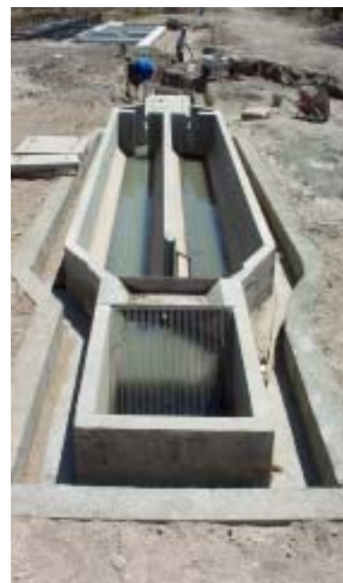
Pre-tratamiento (rejass y desarenador), Santa Ana del Norte, El Salvador; foto cortesía de Julián Monje.
