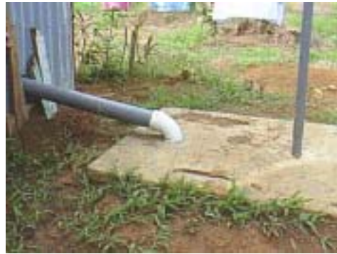
Fosa séptica y tubería de ventilación para letrina que funciona con 2 o 3 litros de agua por descarga. Fotografía tomada por Ing. Elías Rosales
