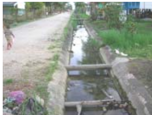
Este canal de drenaje, en Bocas del Toro, Panamá, tiene conexiones ilícitas de aguas servidas sin tratamiento
