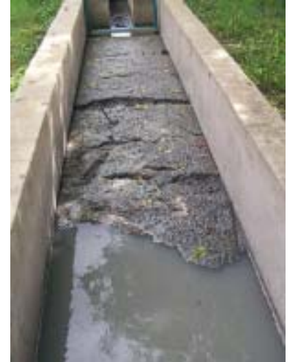
Desarenador y trampa de grasas a la entrada del Biofiltro en Masaya, Nicaragua. Fotografía tomada por unidad Aguas residuales del AyA, Costa Rica
