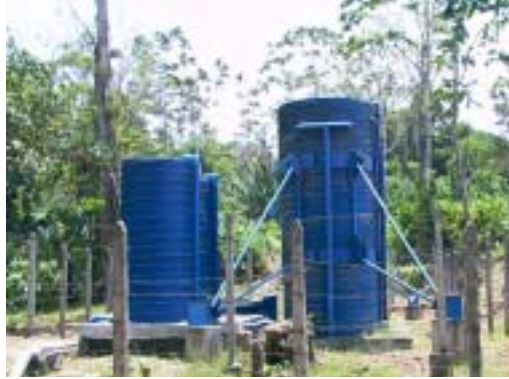
Planta Durman Esquivel en urbanización Atlántida, Limón, Costa Rica. Fotografía tomada por unidad Aguas residuales del AyA, Costa Rica
