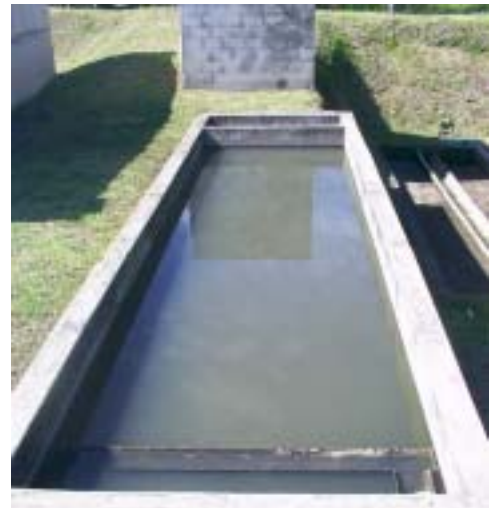
Cámara de contacto y desinfección por cloro. Urbanización Bosques de Santa Ana, San José, Costa Rica. Fotografía tomada por unidad Aguas residuales del AyA, Costa Rica
