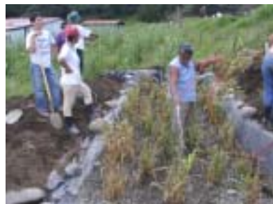
Plantas colocadas sobre el lecho filtrante
