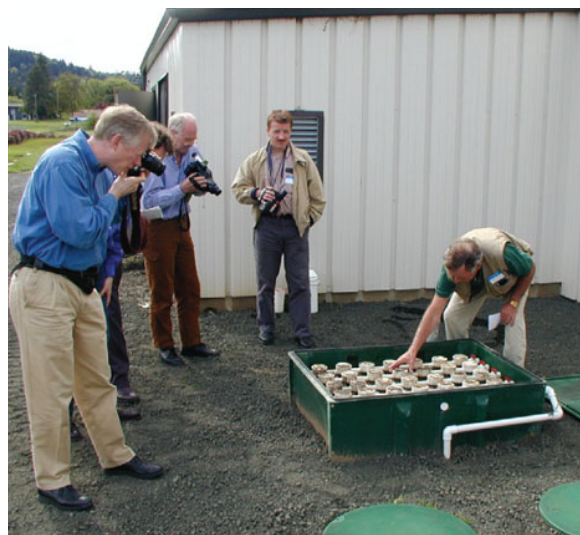
Figur 3-11. Orengo forfilter med spredesystemet avdekket. Filteret på bildet er normal størrelse for en bolig (Orengo Systems Inc.).
