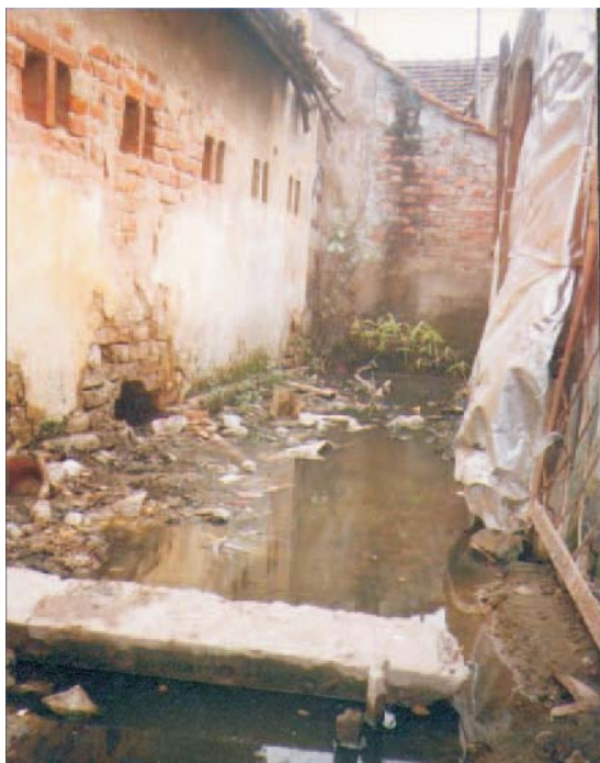
Figura 7. El ambiente en asentamientos humanos puede ser altamente afectado por la contaminación de las aguas superficiales que constituyen el mayor riesgo de transmisión de enfermedades y de criadero de insectos vectores. La introducción de la recolección seca de la materia fecal y la recolección separada de la orina podrían reducir los riesgos sustancialmente. Adicionalmente, se debe promocionar el manejo de las aguas grises.
